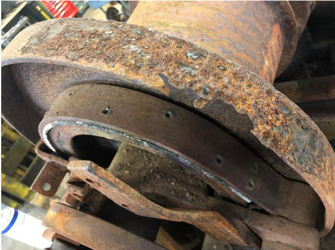
29. april 2021 Bremsetromlene for vaier var rustet og det måtte sveises inn nye stykker
